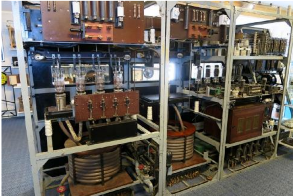
Stativets baksida på Göteborgssändaren
