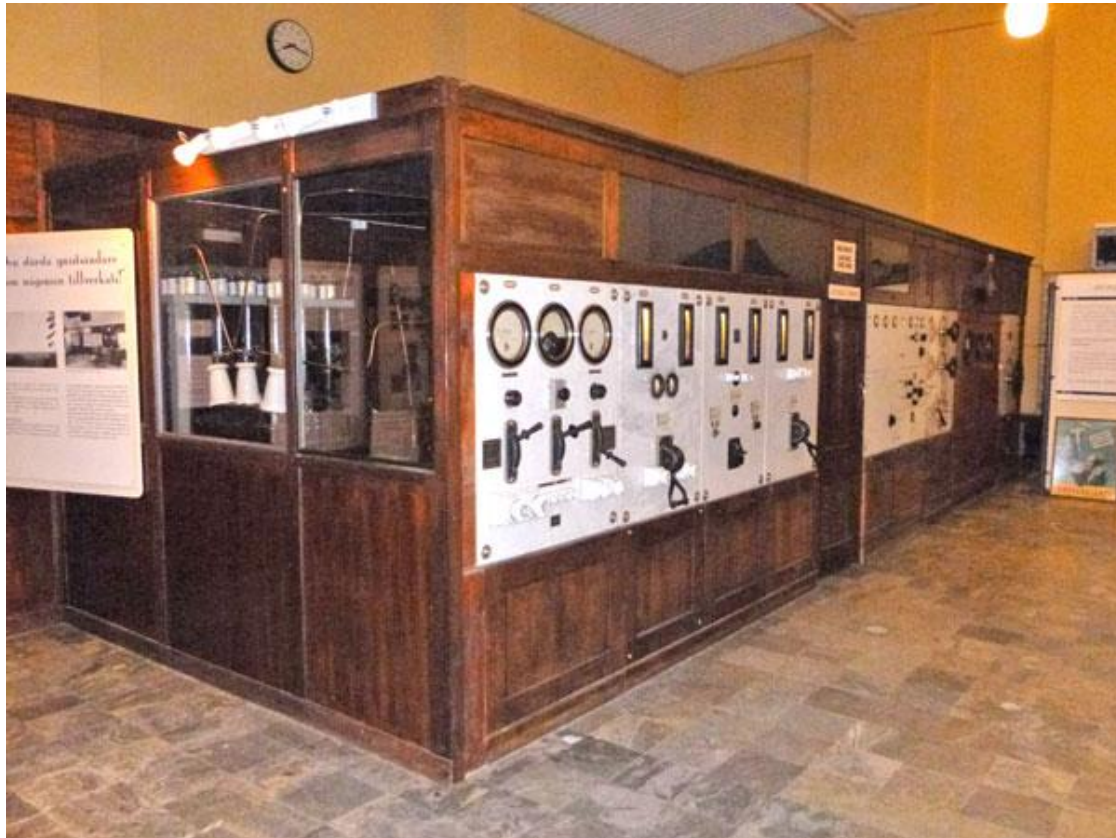
Sändaren från Karlsborg med sin träpanel och marmortavlor
